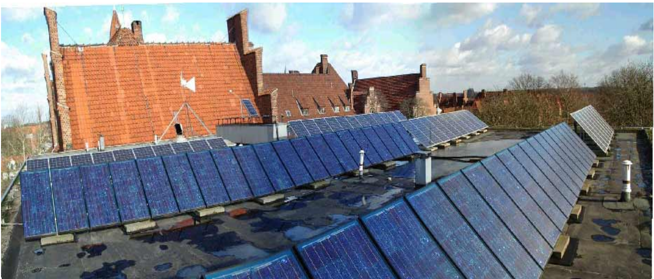
PV-Anlage Wilhelm-Raabe-Schule; 11,54 kWp
