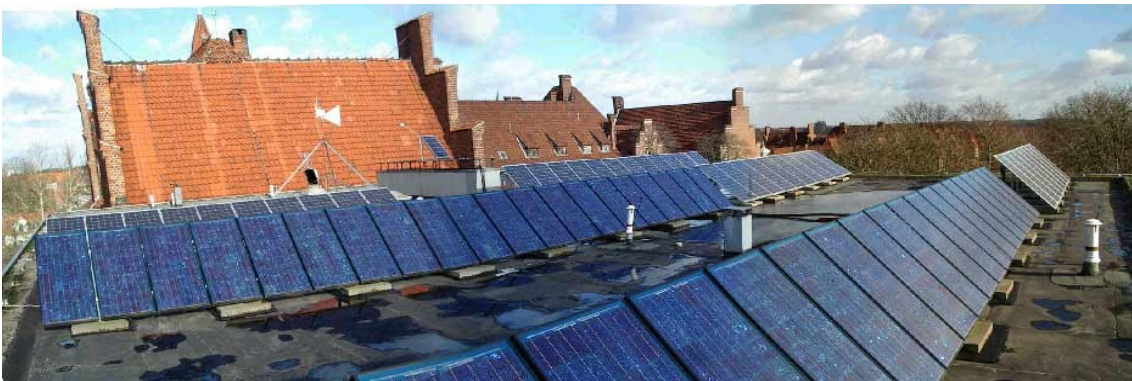
Vorbildlich bunte 11,5 kWp Bürgersolaranlage der WRS . 1998-2005 von Karsten Riggert mit Schülern geschaffen für ca. 20 % des Schulstromes. - Foto nur frei mit diesem Hinweis!
